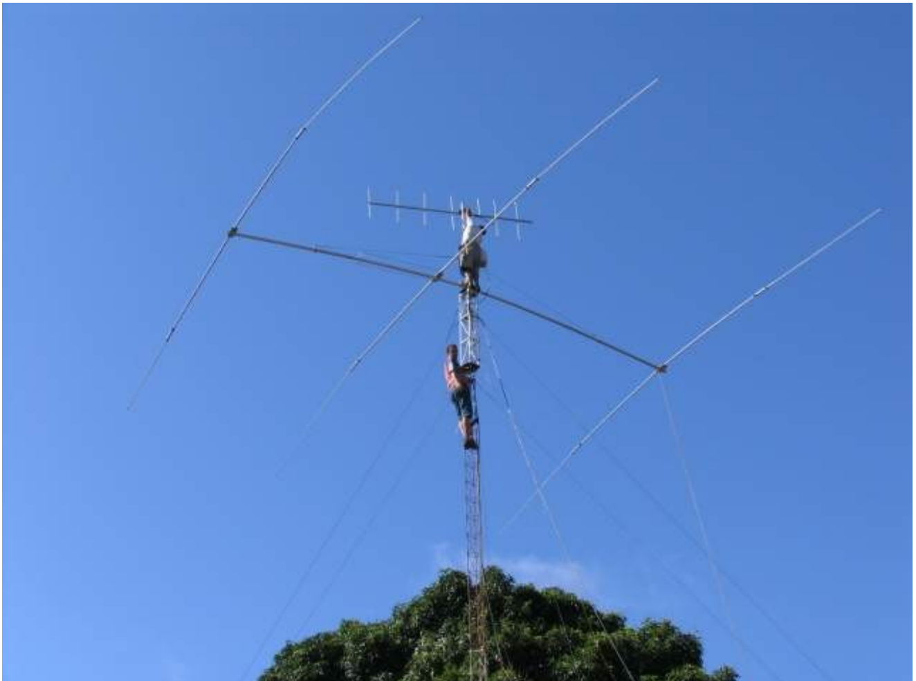
Radioamadores instalando antenas numa torre de 18 metros. Observem que eles estão usando cintos de segurança, ítem obrigatório para quem sobe em torres.
